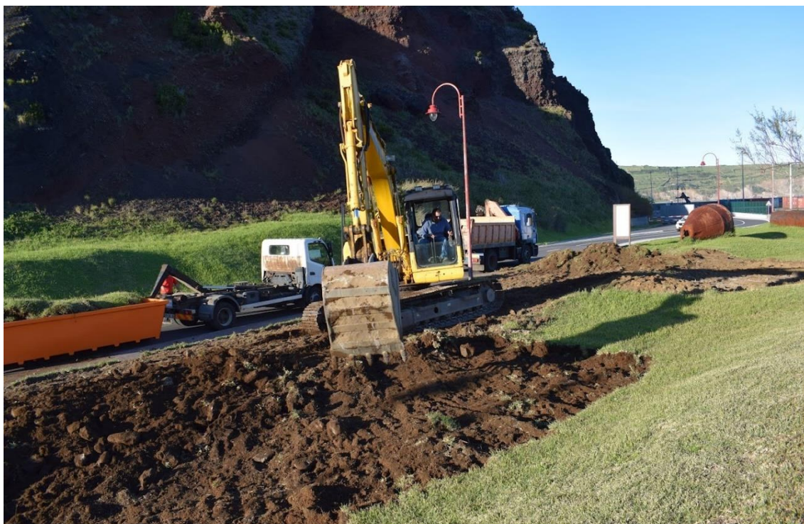
Figura 2 - Remoção de relvado no Monte da Guia com recurso a maquinaria pesada
